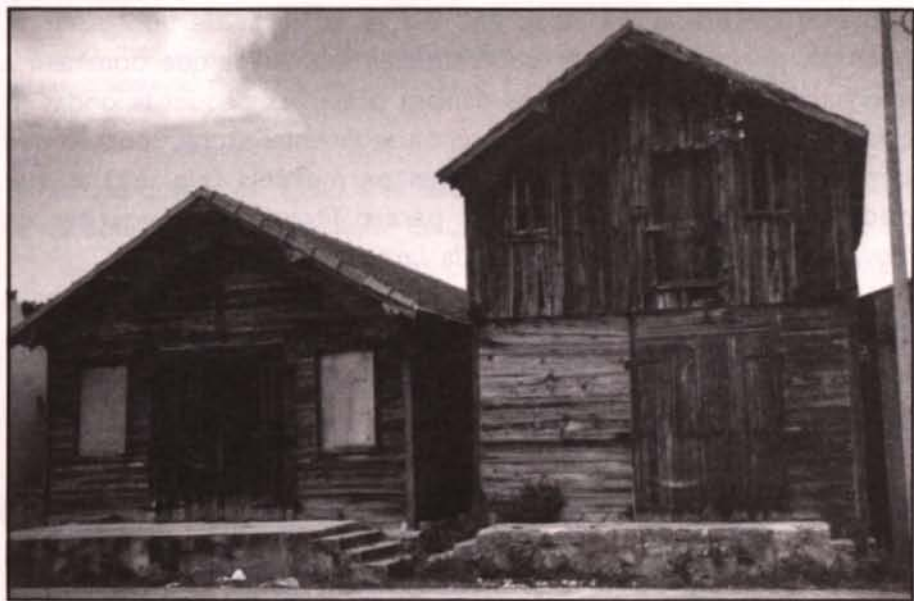
Foto 36 - Dois exemplares de "palheiros" na povoação da Gala, abandonados e em muito mau estado de conservação. Grande parte deles foram abatidos, ou descaracterizados irremediavelmente (7/Abril/1998).
