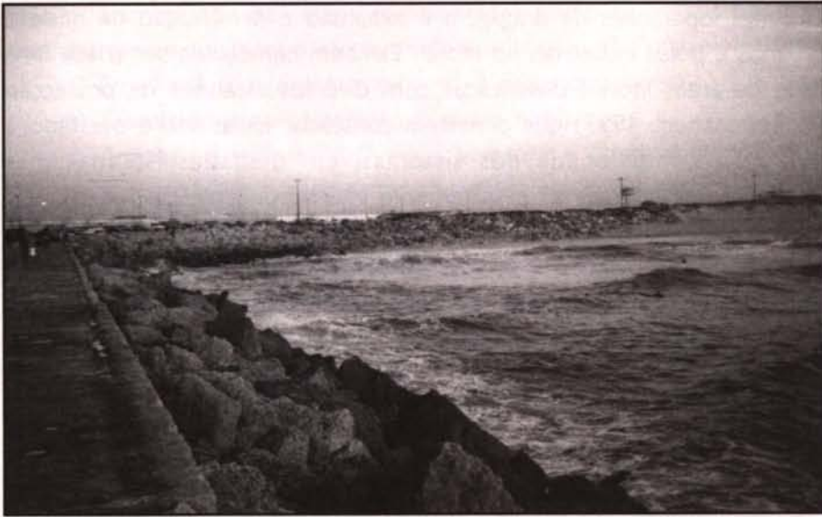
Foto 38 - O recuo da praia e a destruição da duna litoral, devidos à forte erosão que se faz sentir a sotamar do molhe sul têm conduzido ao crescente reforço da protecção pesada que acentua o processo erosivo. De notar a marcada arriba de erosão da estreita duna marginal (à direita) que separa a praia da estrada (7/11/1999).
