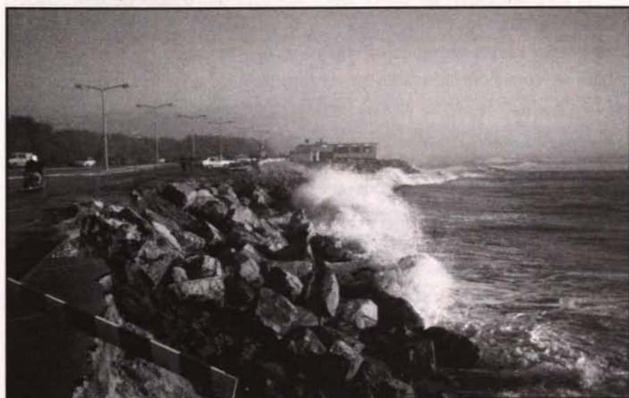
Foto 2 - Poder destrutivo das vagas sobre o muro da "marginal oceânica" da Figueira da Foz (Outubro/1996).
