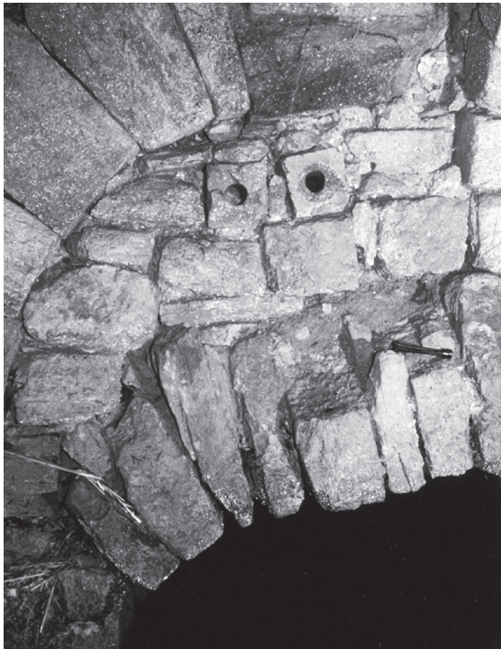
Fig. 10 – Canalisations souterraines à l'abbaye de Trois-Fontaines, emploi de petites canalisations en terre cuite dans la maçonnerie
