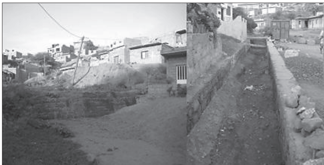
Figura 17 Exemplos de obras estruturais de correção torrencial (dique e canal de drenagem), S ta Rosa
