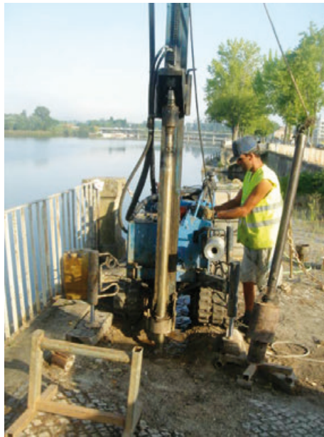
Fig. 3 - Equipamento utilizado na execução das sondagens, durante a realização da sondagem S4.
