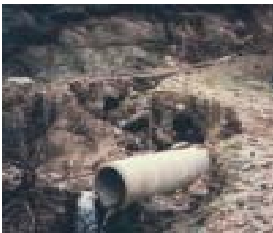
Fot. 2 - Pormenores de aspectos erosivos produzidos na estrada de acesso à Quinta de Belide (Góis), durante o Outono e o Inverno de 1990/91.
