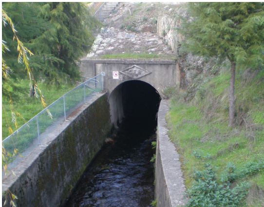
Fot. 12 - Detalhe da saída do túnel do Ceiroco, na ribeira do Samessugo, junto à Malhada do Rei (fotografia de Carlos Cruz).
