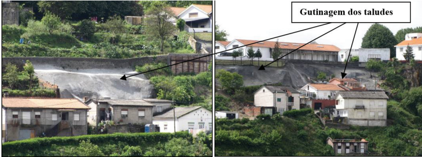
Fot. 14 - Locais de gutinagem dos taludes.
