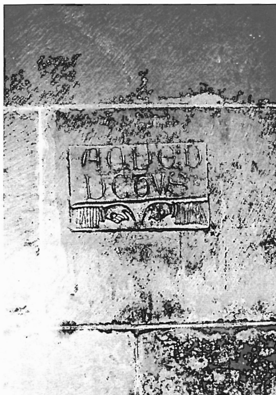
Foto 3 - Expressivo "guardião técnico" no Alçado interior da Nave Colateral Norte, assinalando o local de passagem de duas condutas de alimentação de Água Potável do Lavabo e da Cozinha (P.TAVARES, 1999).
