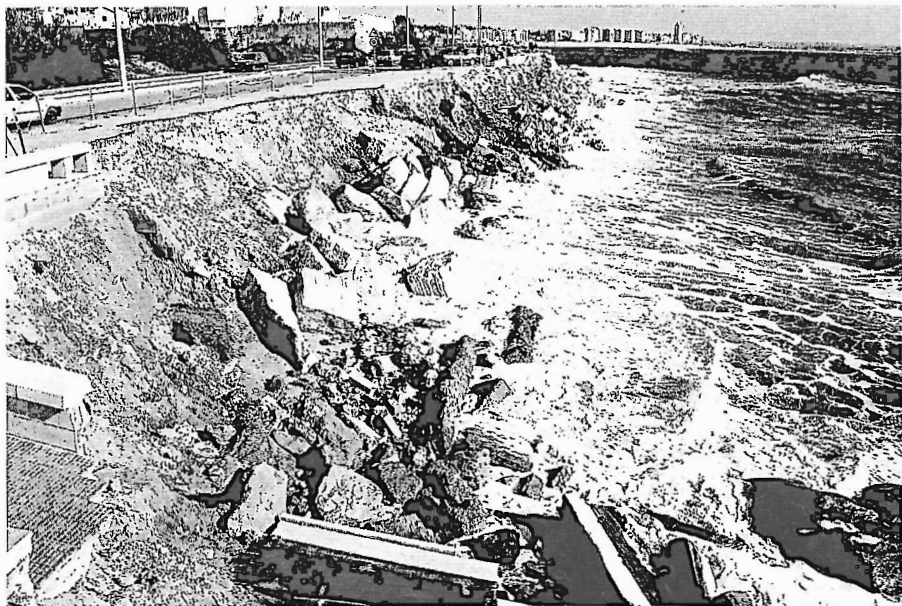
Foto 4 - Aspecto da destruição do enrocamento da Marginal Oceânica, junto do cemitério de Buarcos (troço Teimoso-Buarcos), durante uma preia-mar de maré viva (altura de 3,8 m Z.H.) e com fraca ondulação (1,5 m de altura) de WNW (9/03/1997). São visíveis os blocos de calcário branco depositados recentemente, mas que não impediram o desmoronamento progressivo da própria estrada marginal. Note-se a completa erosão do prisma arenoso da praia, que atingia 2,5 m de espessura na antiga frente do enrocamento, aflorando o substrato rochoso do Jurássico Superior. Em primeiro plano estão os destroços de uma escadaria de acesso à praia.
