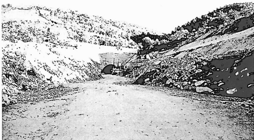
Fot. 4 - Pormenor da abertura do Túnel da Gardunha e da quantidade de material rochoso posto a descoberto.
