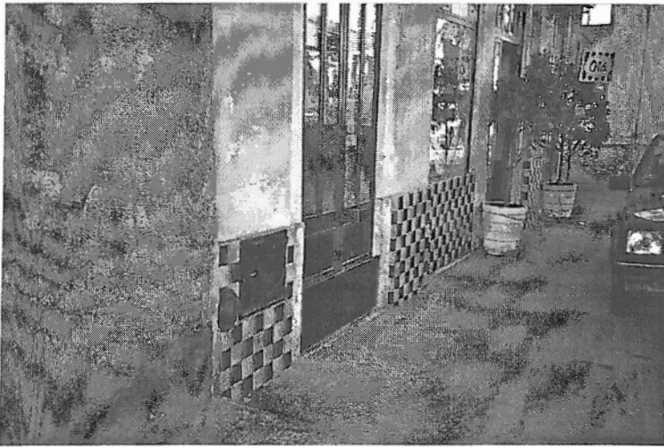
Fot. 7 - Coimbra - Rua do Brasil: protecção contra inundações.
