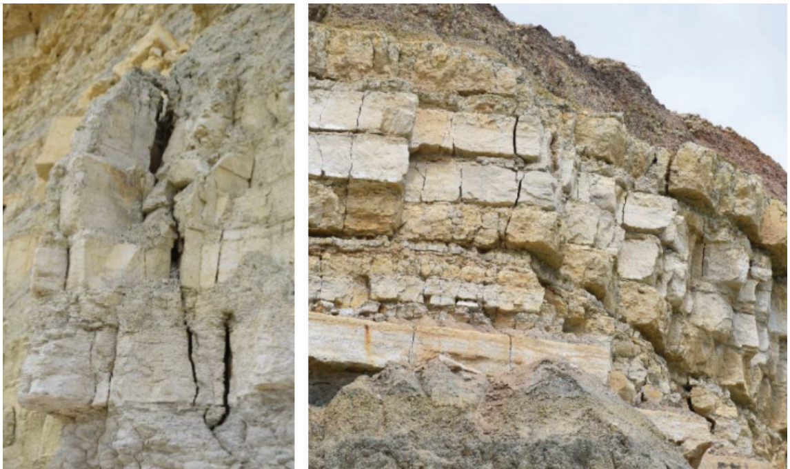
Fot. 1 - Blocos rochosos soltos numa situação de equilíbrio limite.
