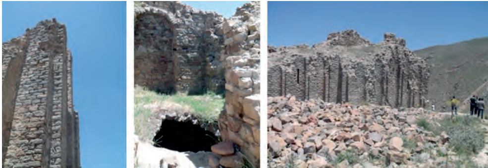
Fig. 6 - Etat actuel du dojo du Ménar; vue Est au dessus des gorges du Fredj et salle du RDC. Source : Cliché de l'auteur, 2014.
