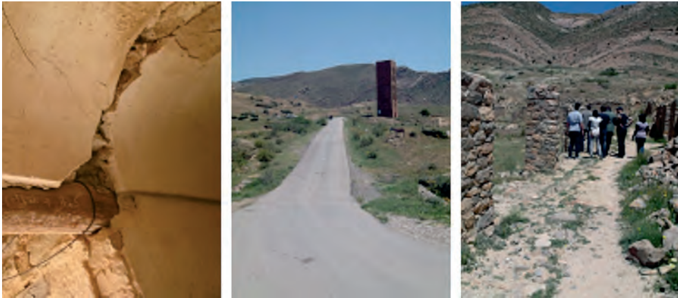
Fig. 14 - De gauche à droite: 1. Fissurations des parois internes du minaret et utilisation de graffitis; 2. Chemin départemental n°6; 3. Piétinement des dallages par les excursionnistes. Source: Auteurs, 2014
