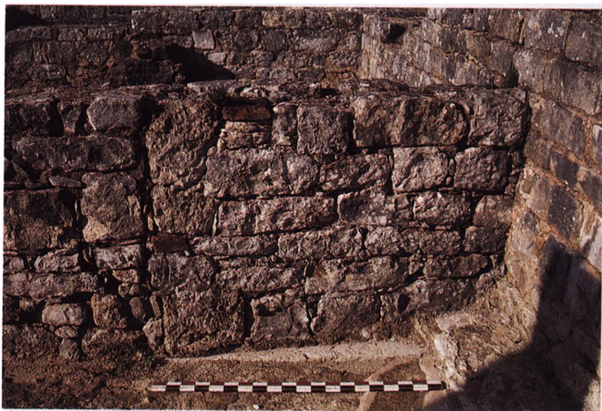
Foto 5 – Fecho da porta sul de C22A (vista do peristilo C23). É visível a soleira original e, no canto inferior direito, o degrau criado sobre o mosaico para dar acesso à porta para as latrinas então aberta.
