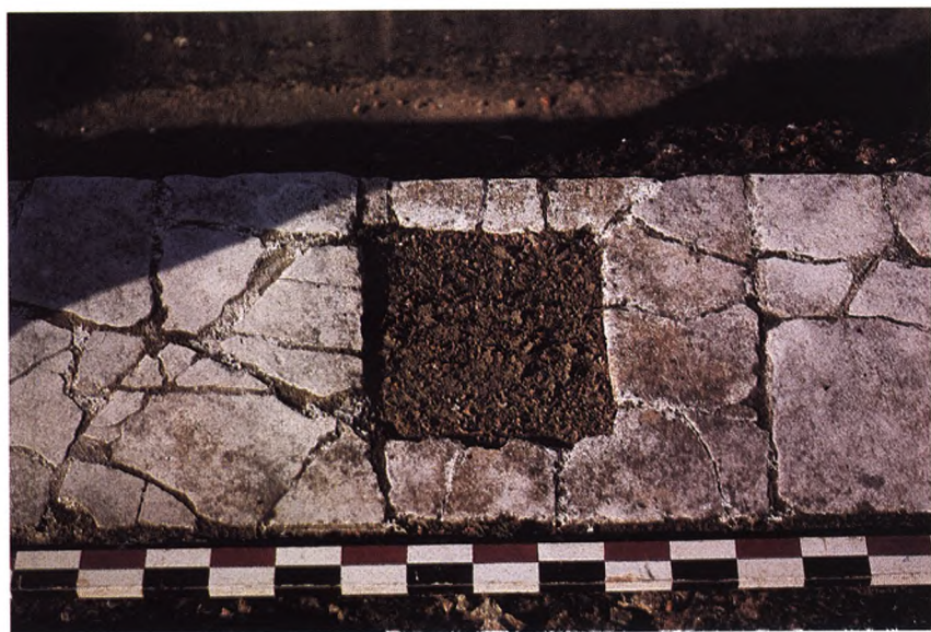
FOTO 2 – Laje calcária entre duas colunas de C10, com recorte destinado à fixação de um plinto.
