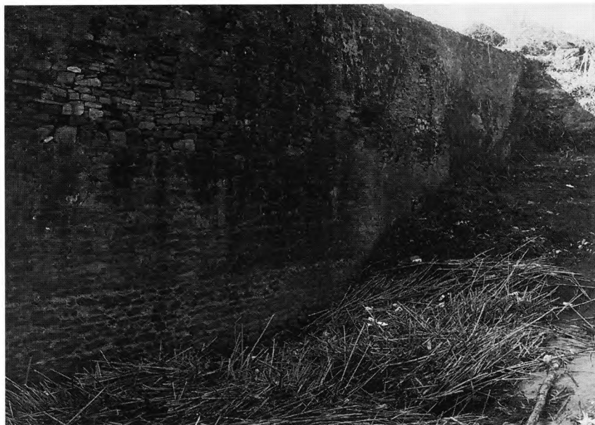
FOTO 29 – Barragem de Alferrarede (Abrantes). Vista do paramento de montante, notando-se, próximo do extremo da margem direita, restos de muro de opus signinum da primitiva barragem romana
