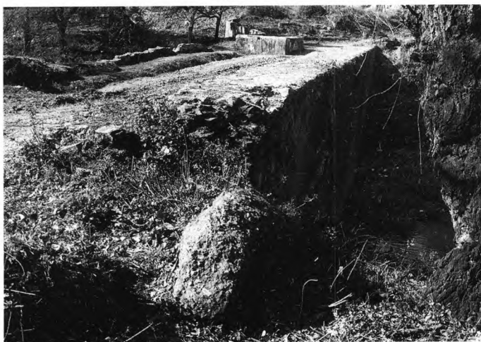
FOTO 28 – Barragem de Alferrarede (Abrantes). Vista do coroamento e do paramento de montante, obtida da margem esquerda. Nota-se, em primeiro plano, um bloco de opus signinum , que pertenceria à primitiva barragem romana
