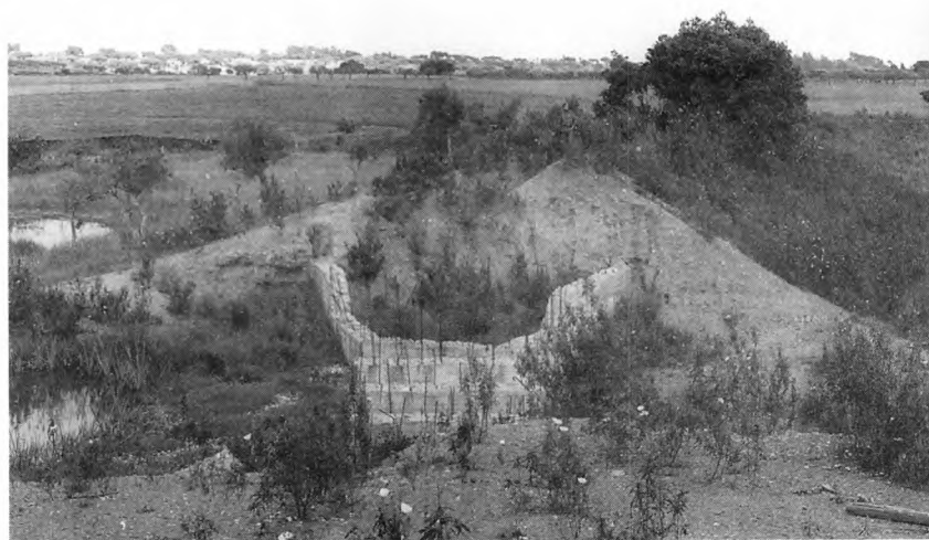
FOTO 24 – Barragem da Lameira (Vila Velha de Ródão). Vista da brecha e da estrutura recente de betão, a partir do aterro na margem direita
