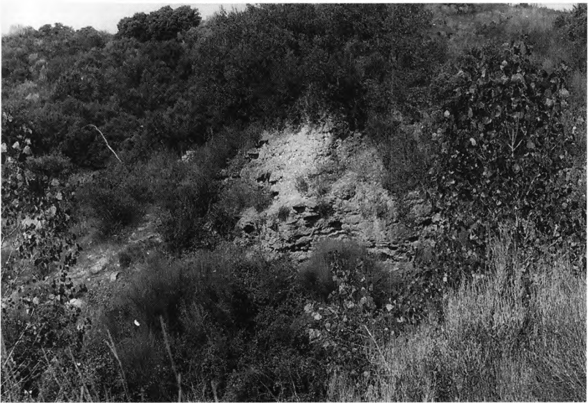
FOTO 15 – Barragem da Egitânia (Idanha-a-Nova). Talude da brecha, da margem direita, observado da margem esquerda
