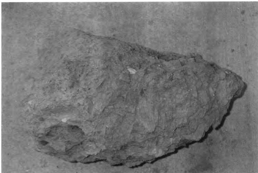
Foto 17 – Barragem da Egitânia (Idanha-a-Nova). Bloco desmoronado do aterro
