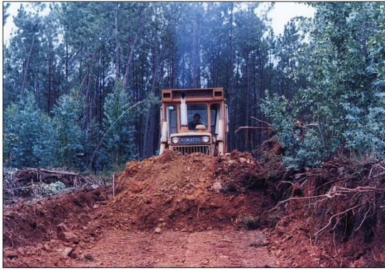
Fot. 12 - Detalhe da abertura de um estradão de acesso à floresta (Fonte: CNEFF, 1999).
