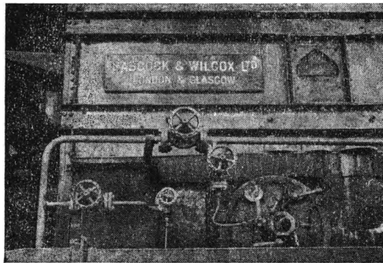
Fig. 7 — Pormenor de uma das caldeiras, do qual se destaca a respectiva marca (fot. de Varela Pècurto).
