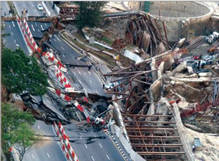
Fot. 23 - Colapso no metro de Singapura, 2004, que levou à abertura de um buraco com 30 m na via Nicoll, adjacente ao túnel (Fonte: Gomes, 2012).
