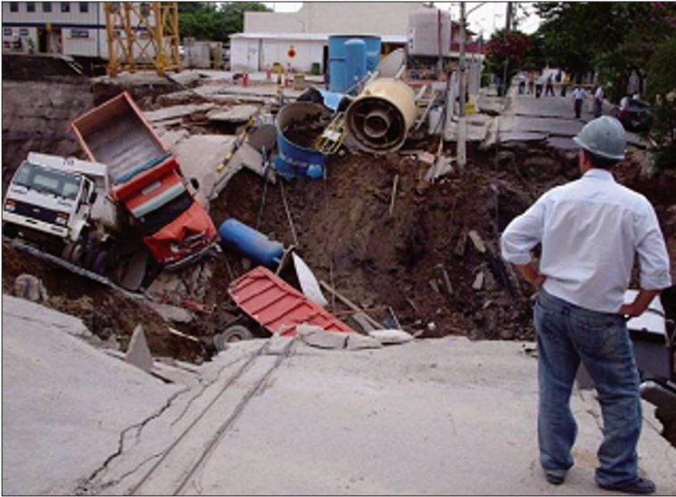
Fot. 22 - Engenheiro observando os efeitos do desabamento de um túnel urbano (Fonte: Guilart, 2007).
