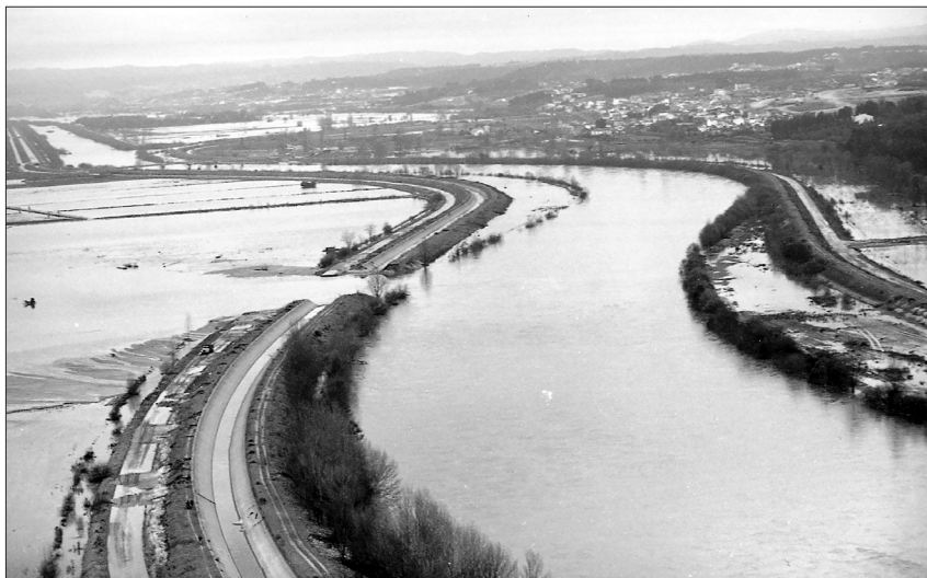
Fot. 8 - Rotura do dique na margem direita do canal principal (Baixo Mondego), junto a Santo Varão, a jusante de Coimbra (Cortesia de Pedro Proença Cunha, Antunes do Carmo, 2017).
