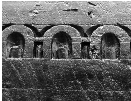
Fig. 20. Detalhe do friso que corre no topo dos painéis onde se denota a aplicação, a posteriori, de vieux-chêne sobre a madeira. 2017, MLNC, ©Arquivo MA.
