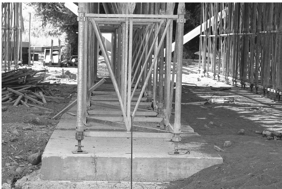
Figura 7.3. Fundação e parte inferior da estrutura de suporte de um cimbra ao solo na obra de construção de um viaduto. (Foto do Autor)
