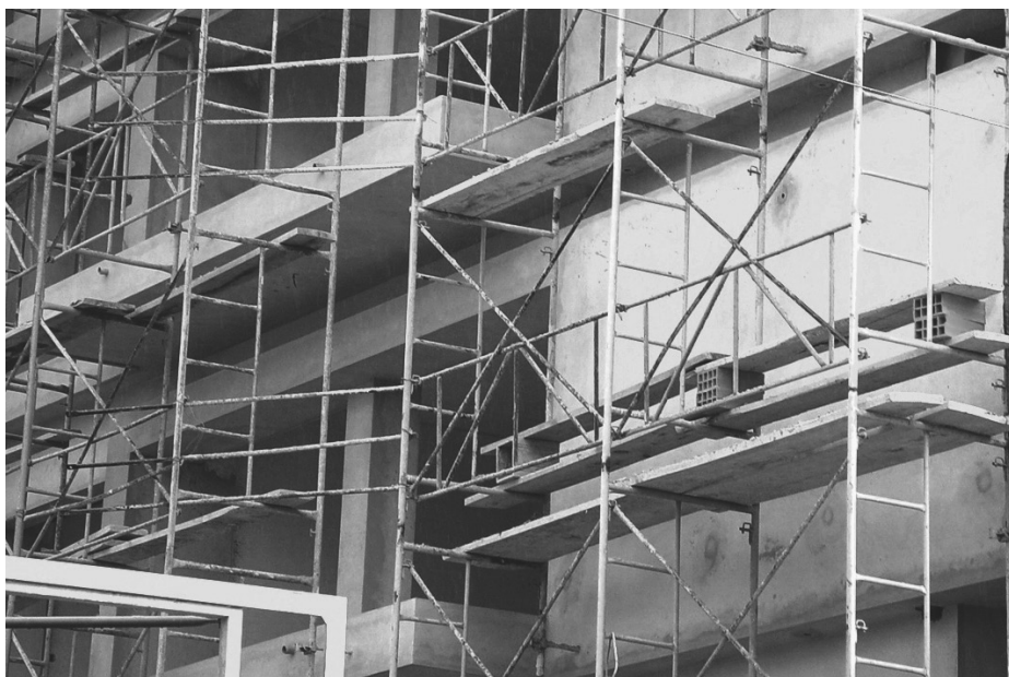
Figura 2.10. Um andaime de poleias sem características aceitáveis de segurança. Note-se, entre outros aspetos, a inexistência de acesso e plataformas adequadas. (Foto do Autor)
