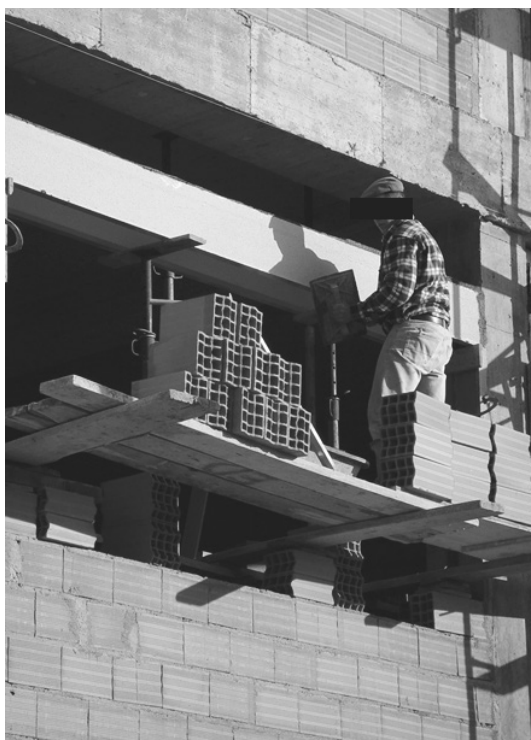
Figura 2.9. Na execução da parede sobre a caixa de estore o operário encontra-se a uma altura de cerca de 11 metros, numa plataforma precária apoiada em tijolos soltos e tabiques deitados. Note-se ainda a aglomeração de materiais na plataforma. (Foto do Autor)
