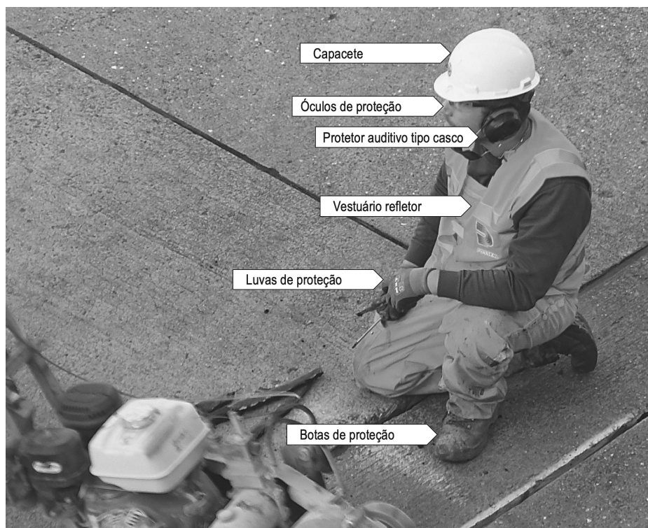
Figura 4.8. O mesmo operário da figura 4.5, relevando-se o uso de diversos equipamentos de proteção individual, na execução da atividade de reparação de juntas de dilatação na pista do aeroporto de Schiphol, em Amsterdão. Compare-se com o operário da figura 2.4 ( Foto do Autor )
