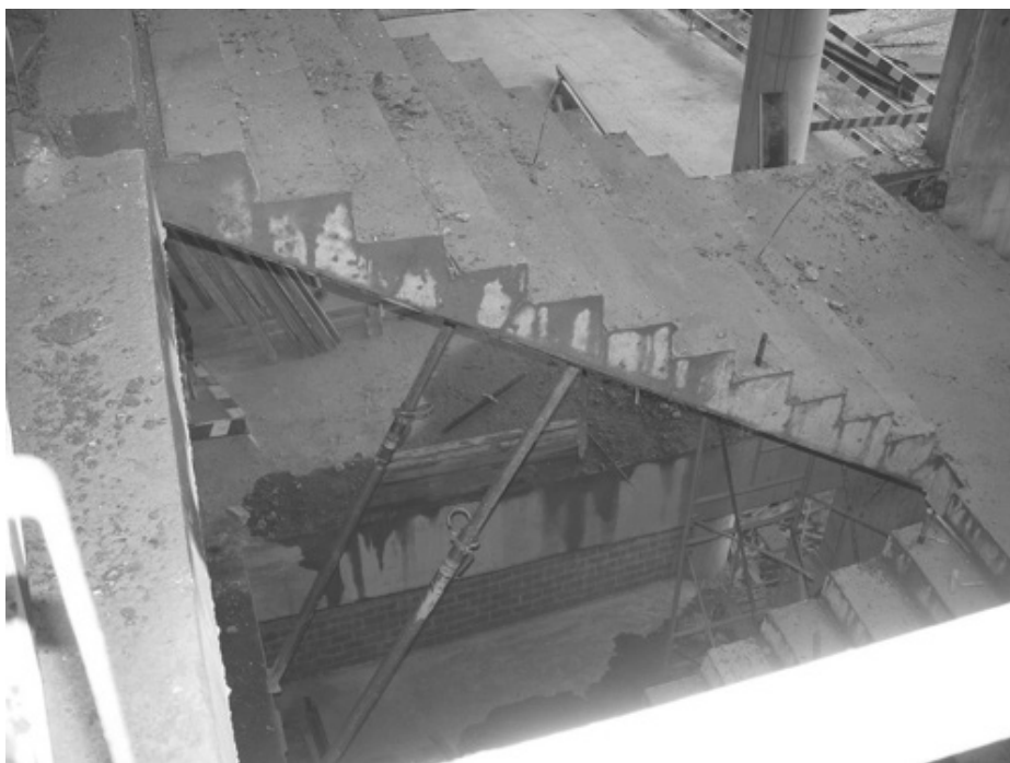
Figura 7.7. Zona de uma obra com elevado risco de queda em altura sem equipamento de proteção coletiva instalado. ( Foto do Autor )
