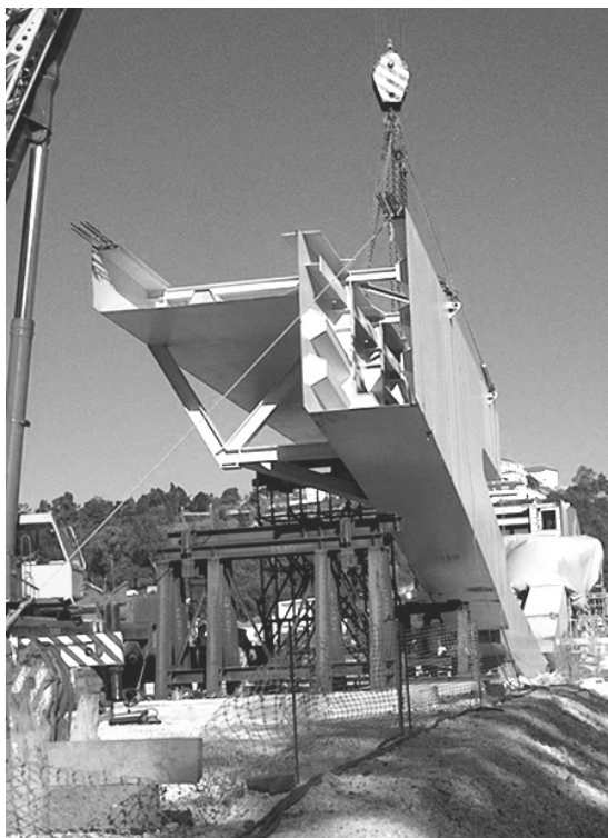
Figura 7.5. A peça da figura anterior prestes a ser colocada no local definitivo. Sob a peça vêm-se os apoios provisórios na ensecadeira.
