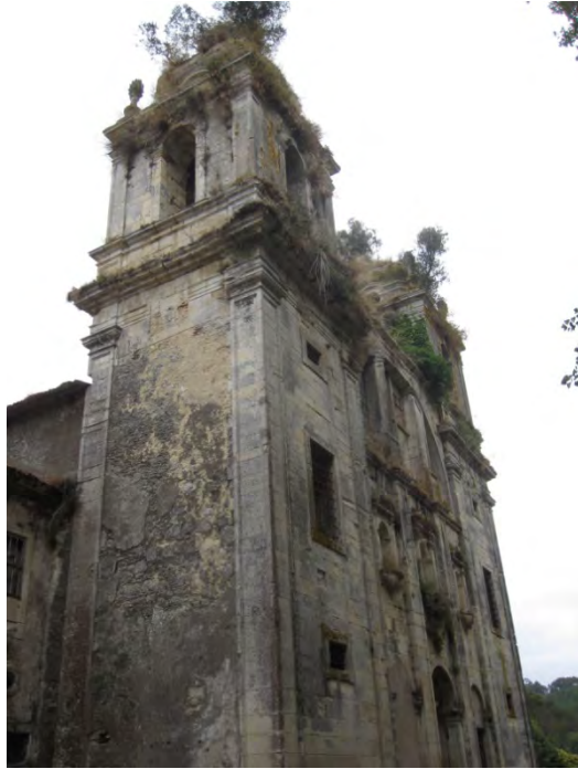
Ilustração 4 - A degradação do Mosteiro de Santa Maria de Seica
