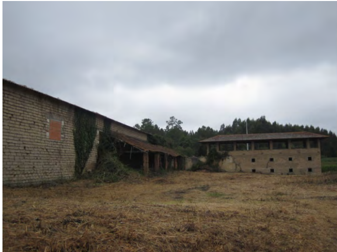
Ilustração 5 - A degradação dos anexos feitos para a fábrica de arroz Fontes: Adriana Antunes
