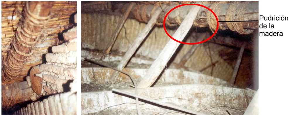
Fig. 6. (a) deterioro de los amarres y (b) pudrición de las vigas
