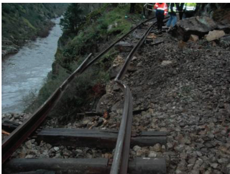
Fot. 3 - Aspeto dos carris após o acidente (Autora: Maria Gouveia, 2007). Photo 3 - Rails' appearance after the accident (Author: Maria Gouveia, 2007).
