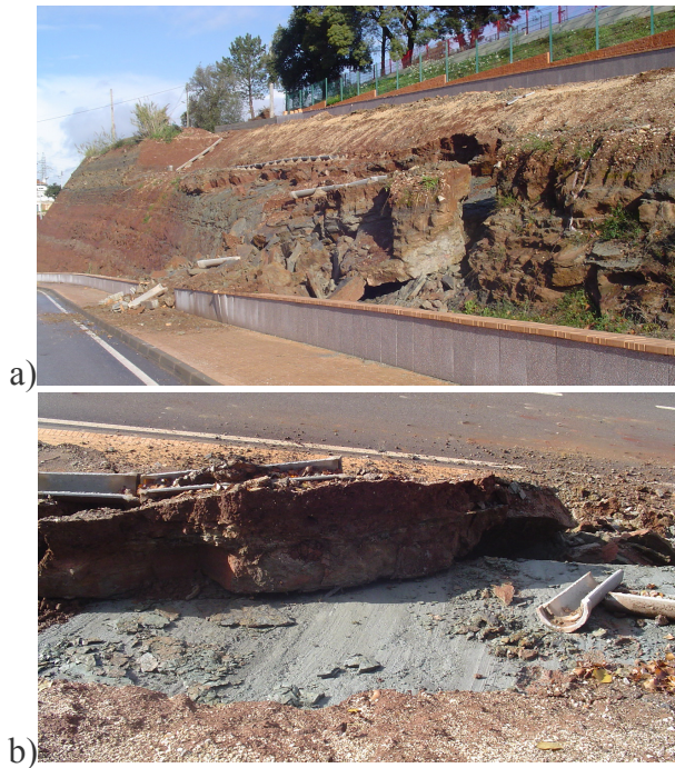
Figura 6. Deslizamento planar no talude Oeste da Escola do Areeiro, ocorrido em Dezembro de 2005. a) Aspecto geral da instabilização que ocorreu segundo uma camada de pelitos na base do termo A2 dos Grés de Silves; b) Bloco deslizado e estrias de movimento na superfície da camada de pelitos.
