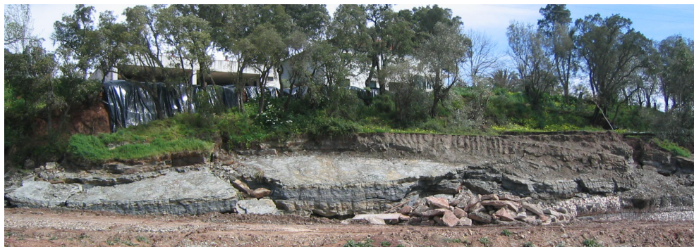
Figura 3. Vista geral da zona instabilizada do talude Este da Urbanização da Quinta do Areiro.
