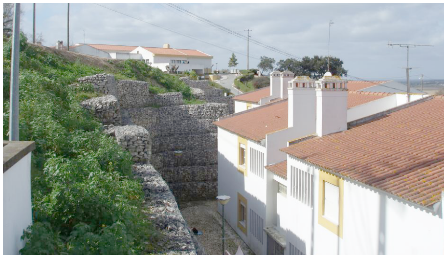
Fot. 13 - Mora (fevereiro 2007) - prevenir crises que possam ser provocadas por deslizamentos ou desabamentos.
